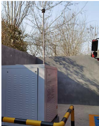
三次油气回收装置
