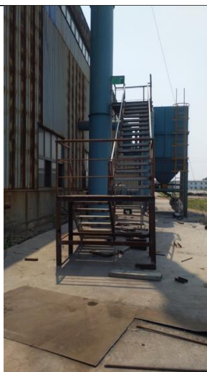
抛丸排放口平台、监测口标识
