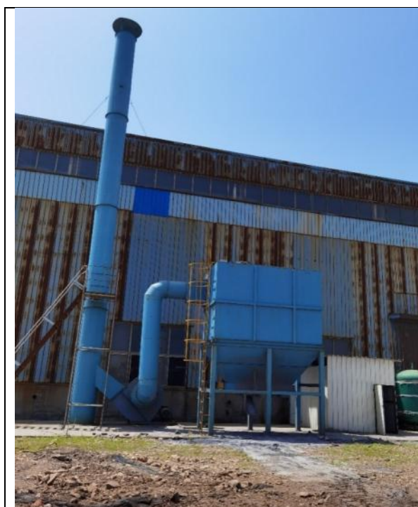
布袋除尘器+排气筒
