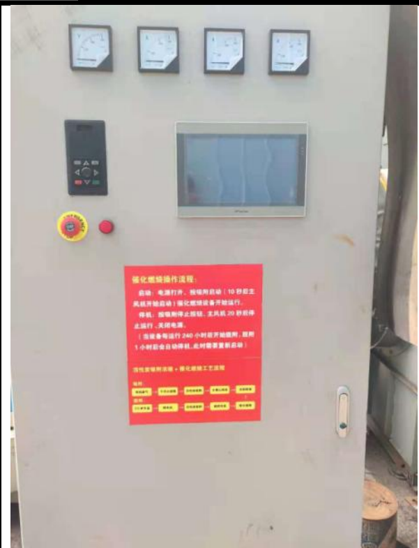
催化燃烧设施操作流程
