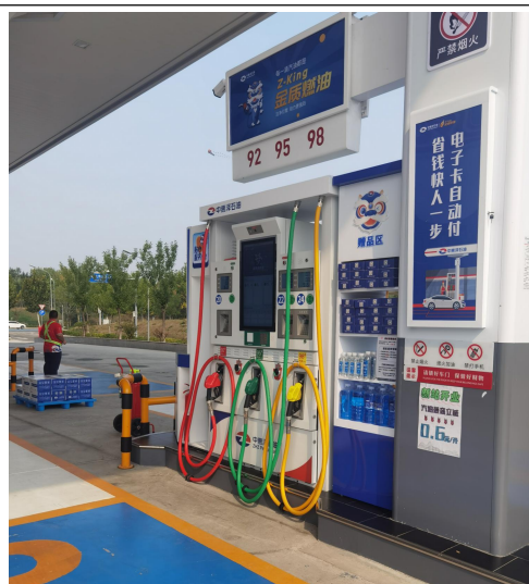
二次油气回收装置
